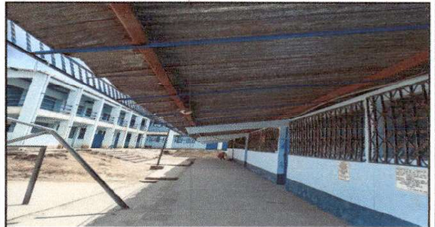
Foto 4: Sustrucción de elementos de fijación, tornillo punta broca pulser
